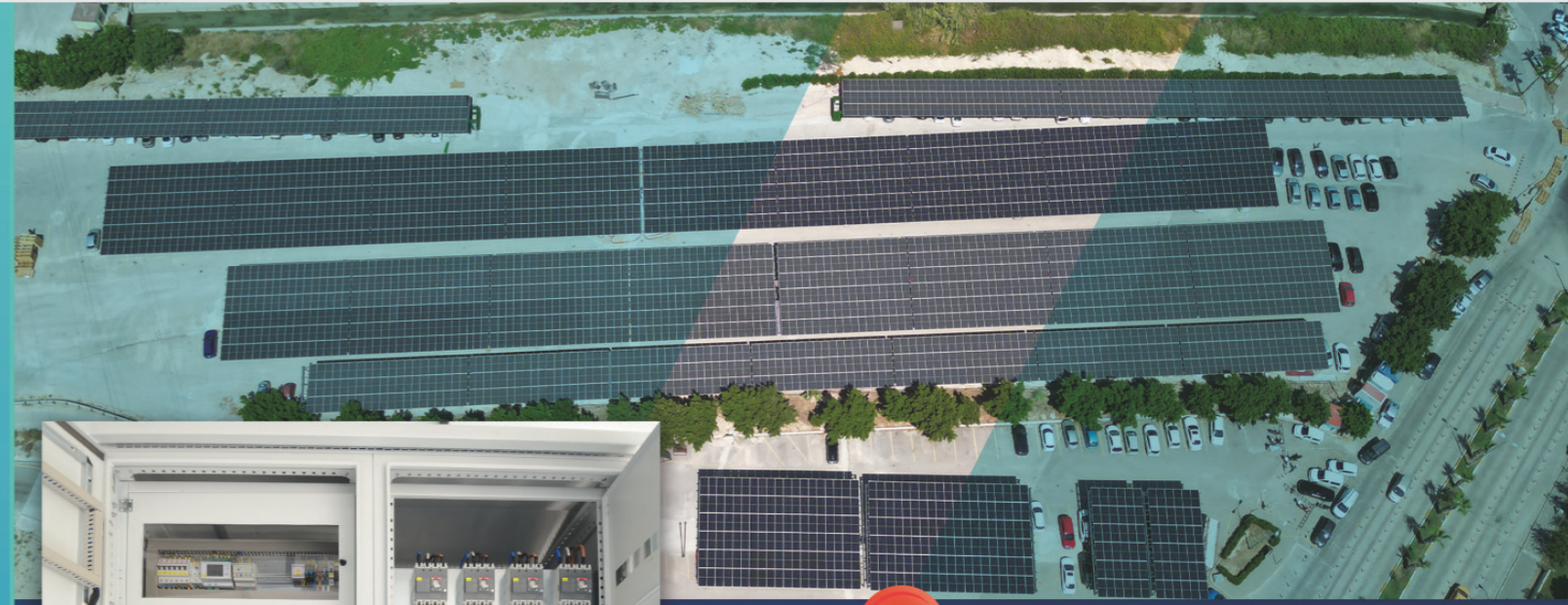
Mersin Üniversitesi İnverter Odası
